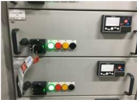
Gambar 3. LOTO pada Sub Station
