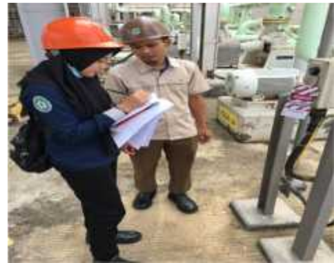
Gambar.4 LOTO pada pompa Gas
